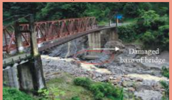
१४ माइल उच्च जल क्षेत्रमा निर्माणाधीन पुलको क्षतिग्रस्त जग
